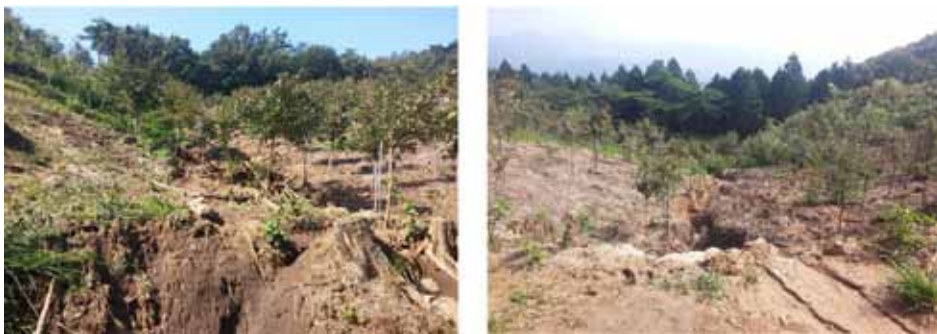
[사진 5-5] 전라남도 순천시 서면 비월리 산 169-1 산사태 현장 전경(사방협회)
