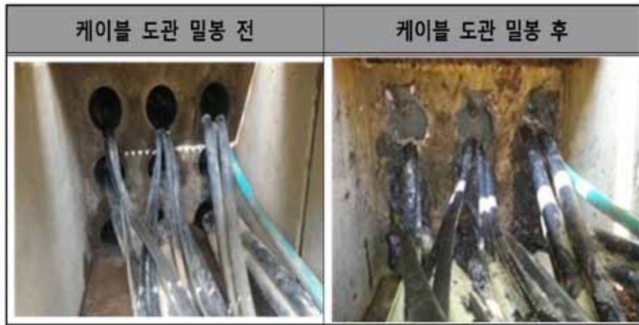
[사진 3-7] 고리원전 2호기 케이블관로 내 순환수펌프실 측 케이블 도관 밀봉 조치 (원자력안전위원회, 2014.9.24)
