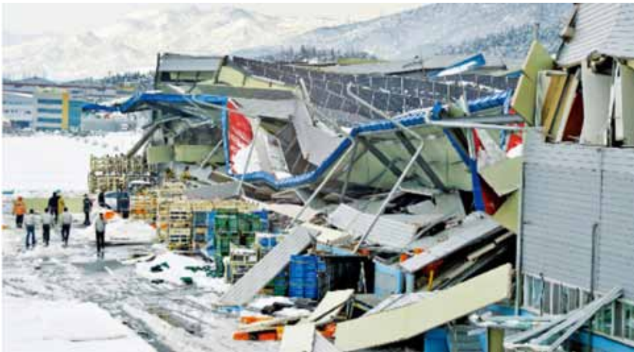
[사진 3-1] 울산의 한 자동차 부품 업체 공장 붕괴 현장 (연합뉴스, 2014.2.11.)
