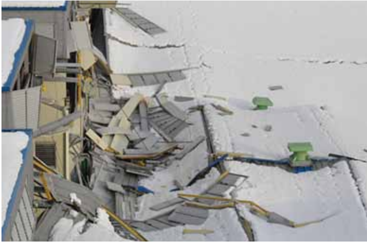
[사진 3-2] 울산 또 다른 자동차 부품업체의 공장 지붕 붕괴 현장 (연합뉴스, 2014.2.11.)
